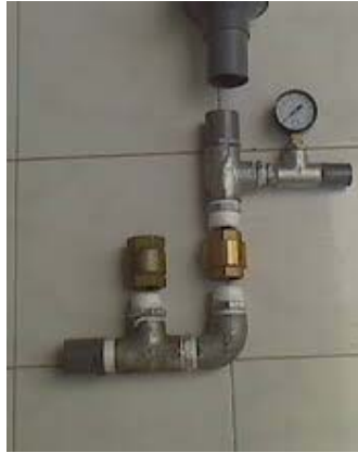
Gb – 08. Sambungan Pompa dilengkapi dengan Pengukur Tekanan
