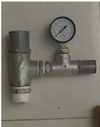
Gb – 07. Sambungan Penyalur Pompa dilengkapi dengan Pengukur Tekanan
