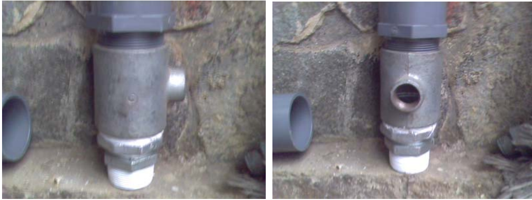
Gb - 20. Pipa Sabungan ke Pipa Penyalur dan Tabung Udara.
