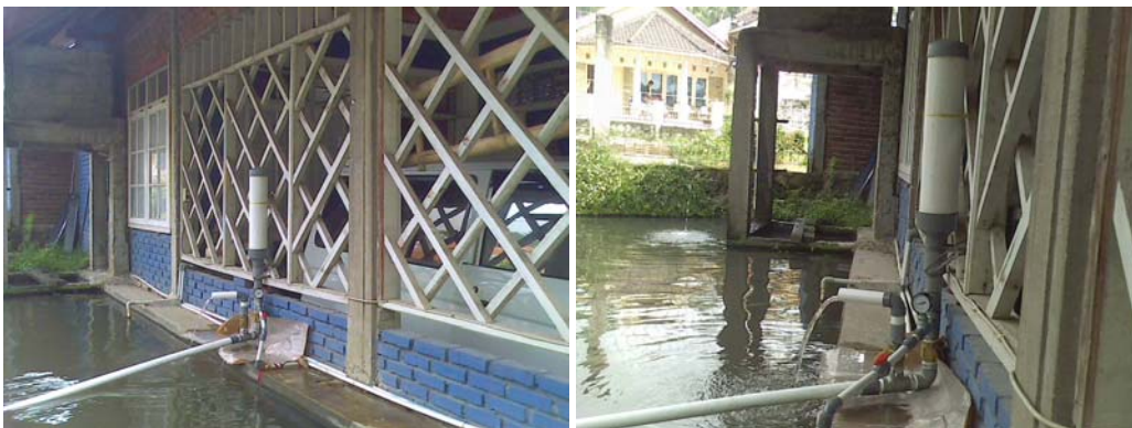
Gb - 15. Konstruksi Pompa sedang berpoperasi.
